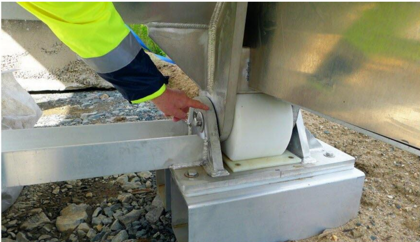
La platine à galet est susceptible de pouvoir légèrement coulisser sur son axe en fonction de la température. (Photo Thierry Huot)
